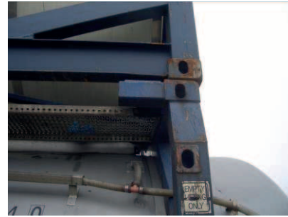
Figura 4.9: Espacio vacío en la abertura para izada lateral secundaria
