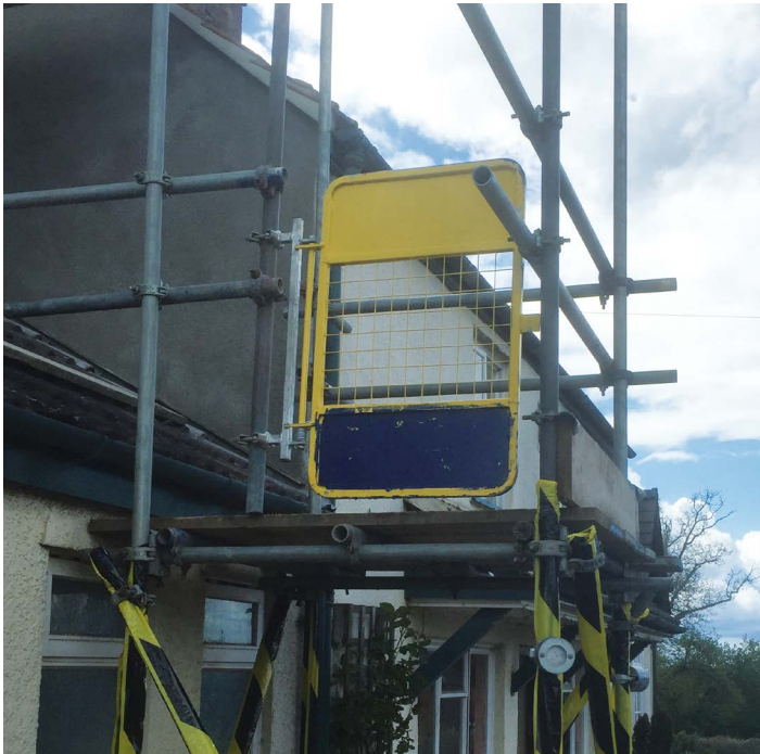
Figure 13. Porte à fermeture automatique au point d'accès à un échafaudage
