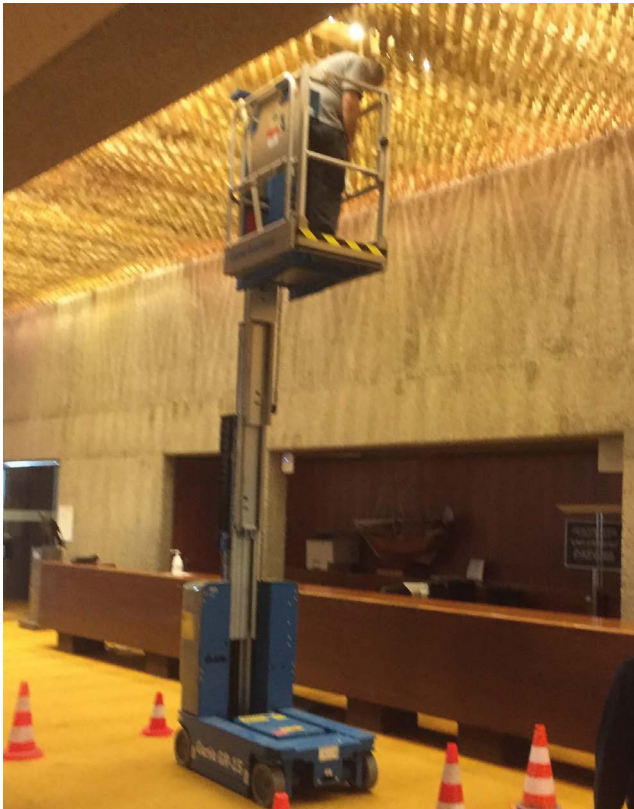
Figure 18. Plate-forme élévatrice mobile de personnel utilisée dans un hall pour remplacer les matériels d'éclairage
